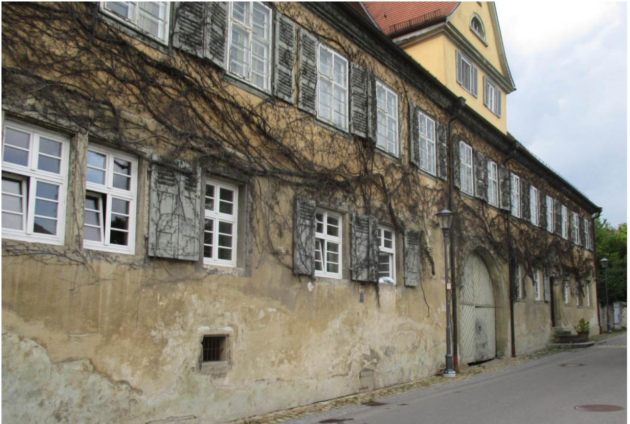
Abbildung 84: Sanierungsbedürftige Fassade des Schloss Gärtringen
